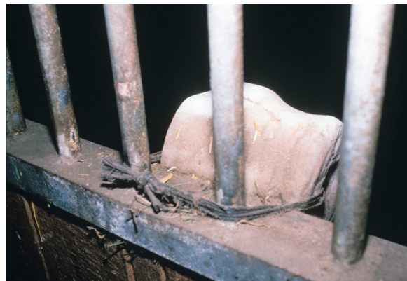
Es haben sich Dreck und Staub angesammelt: hier sollte dringend gereinigt werden
